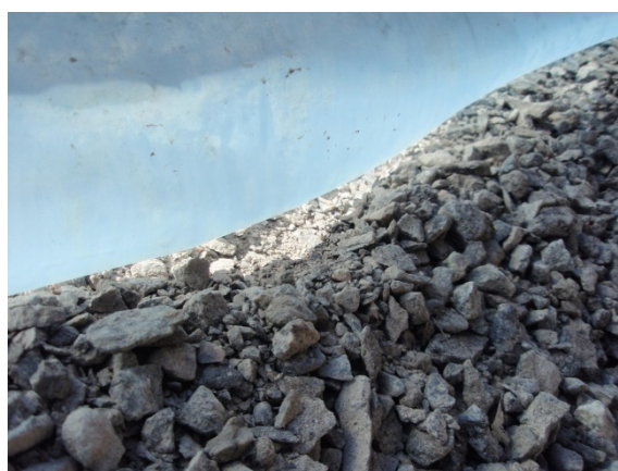
Bild 3. Kraftiga vindar slet upp plastduken från marken.
