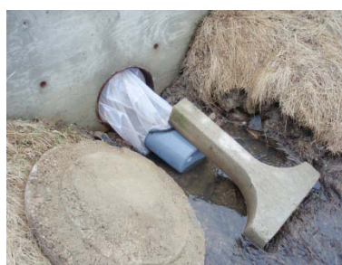
Bild 2. Fälla i kraftigare vattenflöde.
