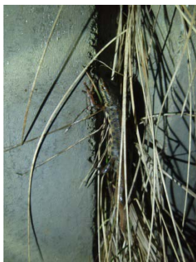
Bild 11. Mindre vattensalamander klättrar uppför barriären i en grässträng som fått fäste i fogen mellan betongblocken.
