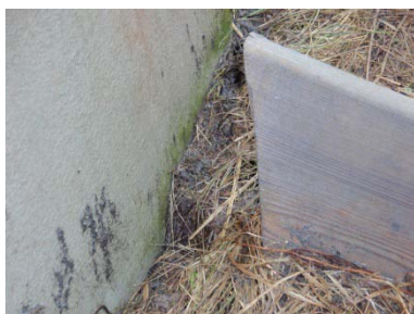
Bild 12. Plankan som skall leda ned groddjuren mot rörmynningen har glidit ned och medger passage förbi rörmynningen.
